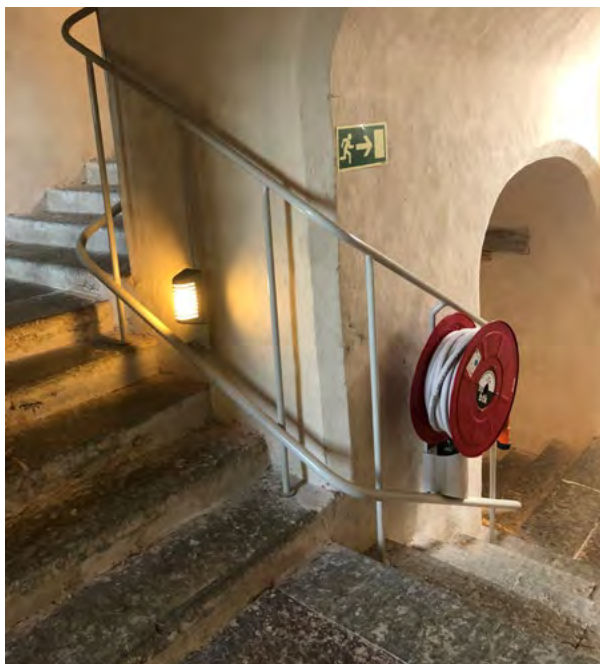
Inomhusbrandposter i trapphuset på Läckö slott med vatten som dragits i handledaren.
