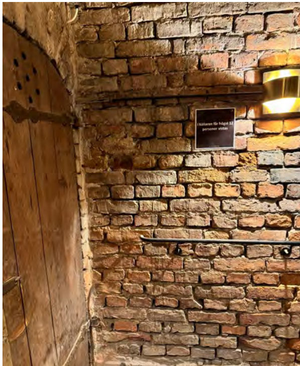
Personantalsskylt med anpassad färg och typsnitt från en källare på Stockholms Slott som enbart har en utrymningsväg.
