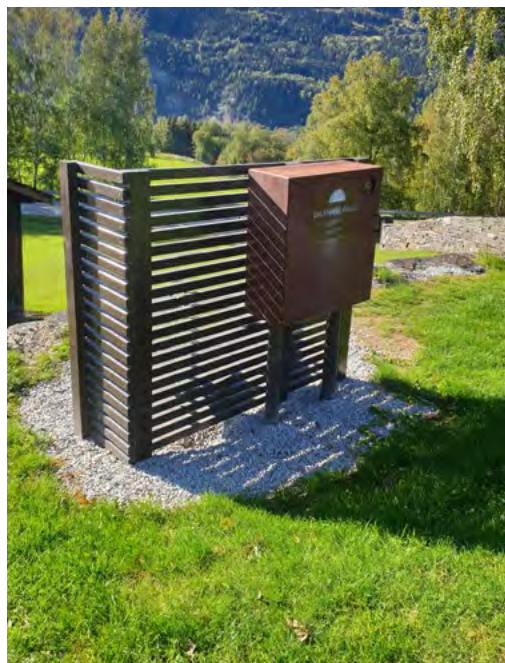
Utvändiga inomhusbrandsposter vid kyrka i Norge för att närboende ska kunna göra en snabb insats mot anlagd brand. Skåpet är uppvärmt.
