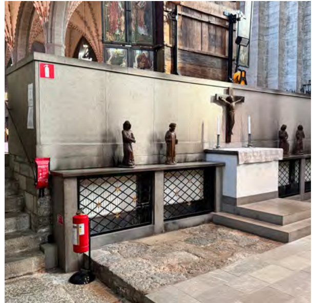
Golvstativ i Vadstena klosterkyrka. Brandfilten finns eftersom levande ljus ofta används i närheten.
