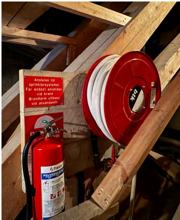
Invändig inomhusbrandpost som är ansluten till sprinklersystemet (torrörssystem) i tornet på Katarina kyrka. Om brandposten används så aktiveras brandlarmet i byggnaden.
