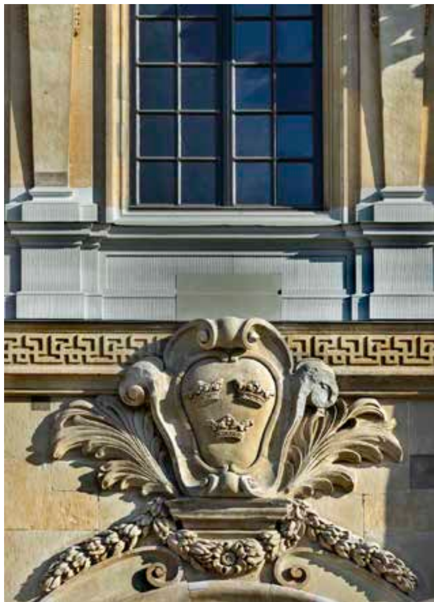
Riksvapnet, ovanför porten till södra valvet, är illa åtgånget. Det nya har tillverkats på ett stenhuggeri i Danmark och kommer troligen att monteras under nästa år.
