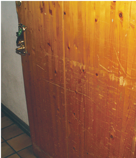
Denna dörr i ett statligt byggnadsminne från 1960-talet har blivit ovarsamt behandlad upprepade gånger.
